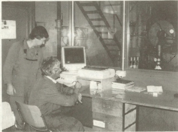
Pogled v "komandni prostor" kotlovnice, ki s toplotno energijo "prehranjuje" celotno tovarno, tako na tehnološkem kot bivanjskem področju.
