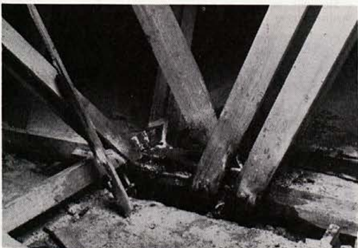
Požar v ostrežju temperirnice 1976. leta
