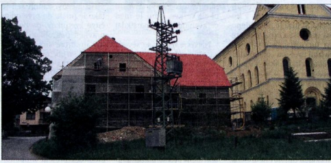
Mogočna stavba takomenovanega starega župnišča v Vojniku, ki je zaščiten kot kulturni spomenik, bo leto poleti dokončno obnovljena.
