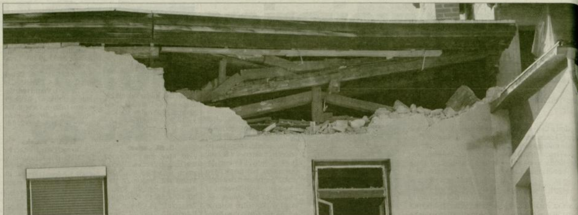
Del strehe in zidu je silovito razmetalo naokrog. Stavba s strani Prešernove ulice pa še danes izgleda nevarno...
