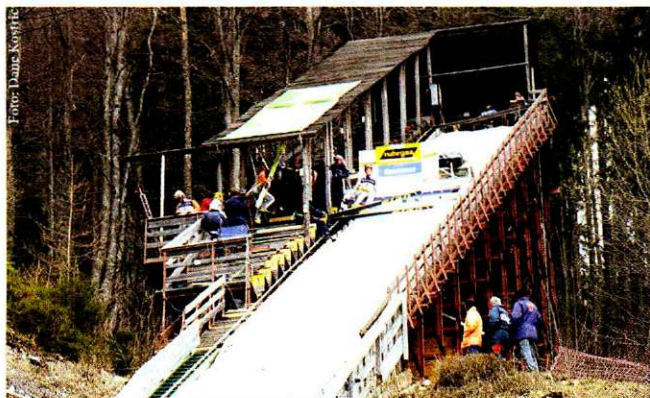
Bloudkova skakalnica iz leta 1953 je dotrajana, zato bi bilo njeno zastarelo konstrukcijo nesmiselno popravljati in dograjevati.
