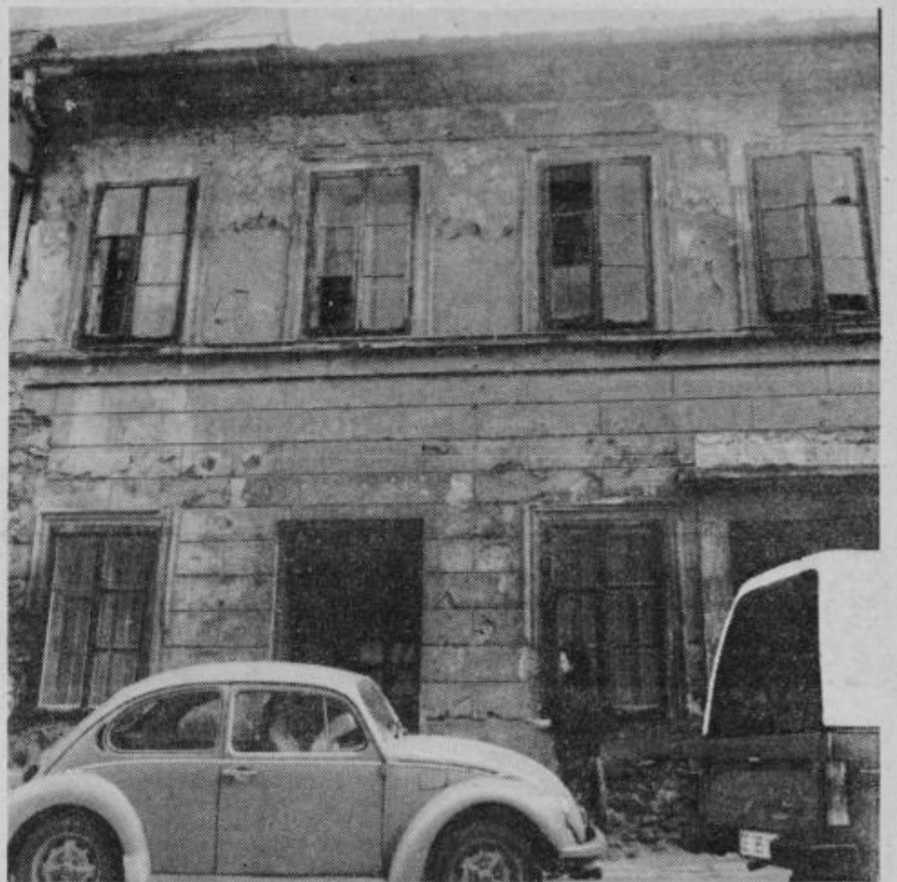
Zidanškova 20 - Zob časa je počasi, a zanesljivo načel hišo. Streha pušča, omet odpada, vrata so uničili vlomilci, vlaga je načela tudi notranjost stavbe. Kupec bo poleg kupnine moral odšteti še približno 4 milijone dinarjev za obnovo hiše.
