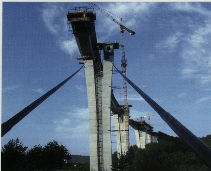
Slika 15 • Pogled na stebre 5, 6, 7, ki so bili med prosto konzolno gradnjo prekladne konstrukcije dodatno podprti s kabli.
