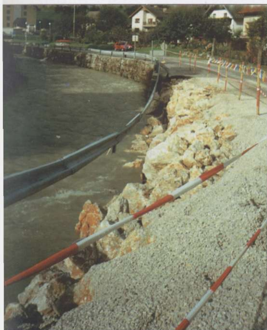
Slika 3: Odnešena cesta na Trnju v Železnikih.
