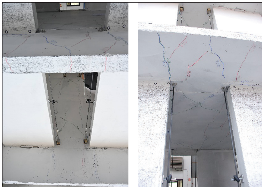
Slika 7 • Razpoke na zgornji in spodnji strani plošč so se razširile po celotni širini plošč pravokotno na smer sten.
