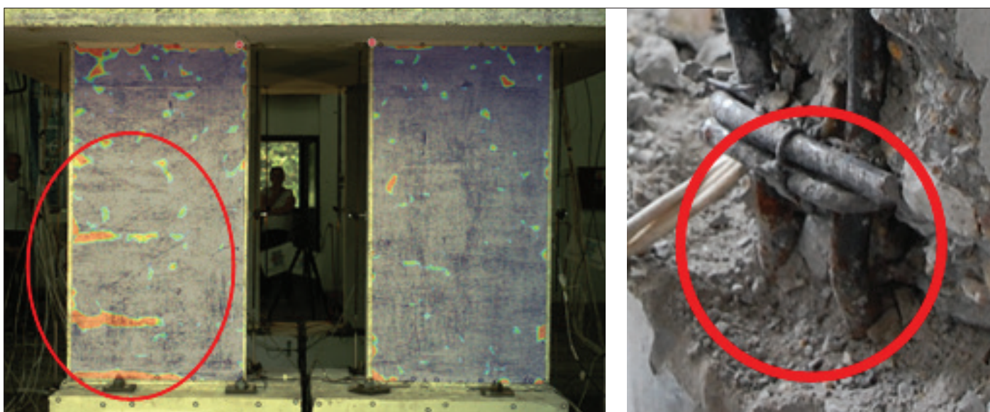
Slika 9 • Odziv dveh slopov ene stene je bil bistveno drugačen (levo), v močno tlačno obremenjenem slopu se je navpična armatura uklonila (desno).
