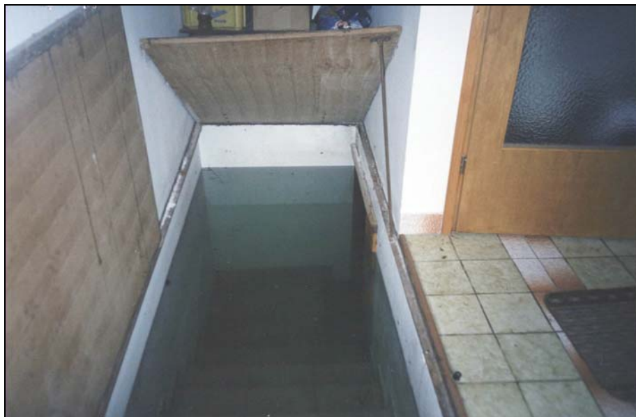
Slika 4: Poplavljena klet v stanovanjski hiši na vzhodnem delu Bača (Arhiv 2001).
