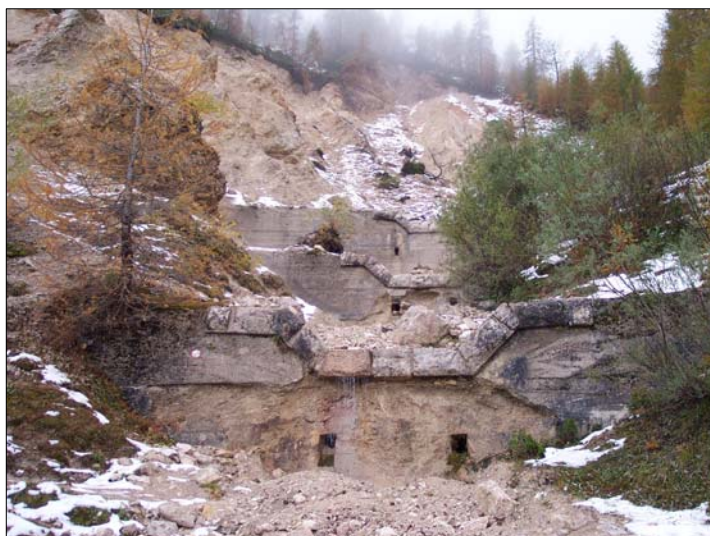
Slika 3: Veliko varovalnih objektov je postavljenih v sistemih. Pri nedelovanju ključnih objektov se lahko poruši ves sistem. Pravočasno vzdrževanje tovrstnih varovalnih sistemov je zato zelo pomembno, kajti praviloma s svojim delovanjem preprečujejo intenziviranje zelo obsežnih erozijskih procesov (primer iz zaledja Velike Pišnice).
