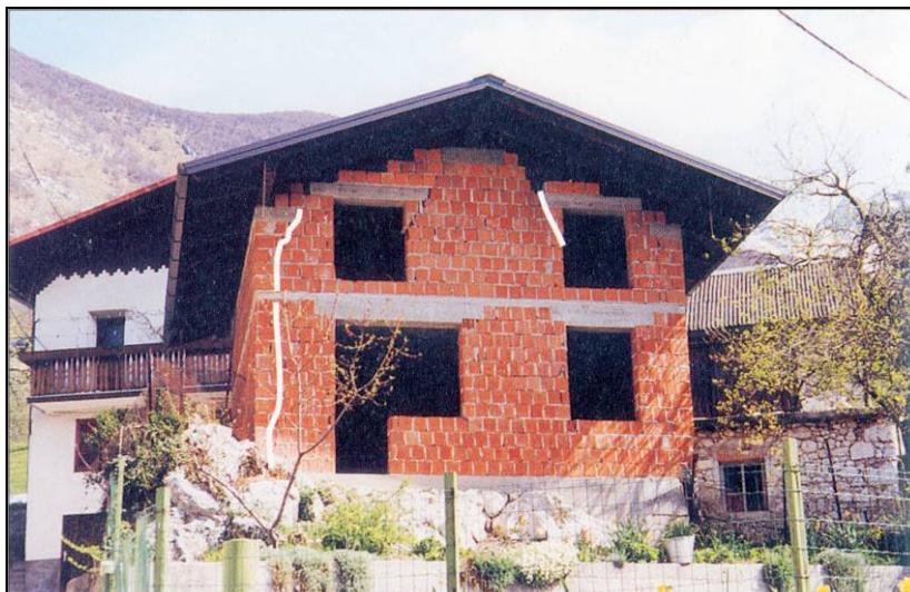
Slika 3: Zaradi konstrukcijskih nepravilnosti je bila stavba, sicer zgrajena iz sodobnih in "okolju tujih" gradiv, močno poškodovana (Drežniške ravne, 1998; fotografija: Živa Deu).
