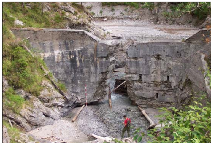
Slika 1: Poškodovana zaplavno-ustalivena pregrada (hudournik Belca).
