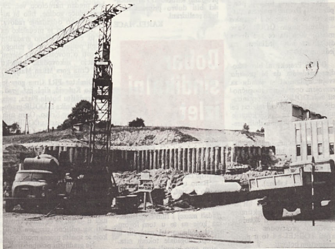
PROGRAM 64 v Novomeški Krki: ko so odpeljali nekaj tisoč kubikov zemlje, se je pokazala velika pilotna stena (foto Andrej Martinčič)
