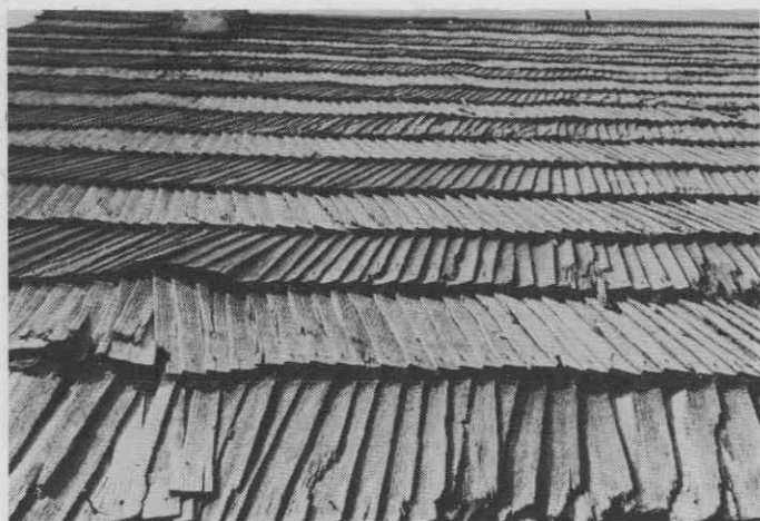
Sl. 6 – Streha na gospodarskem posloplju gostinskega obrata gozdnega gospodarstva na Glažuti pri Kočevju – Foto: F. Šarf, junij 1975
