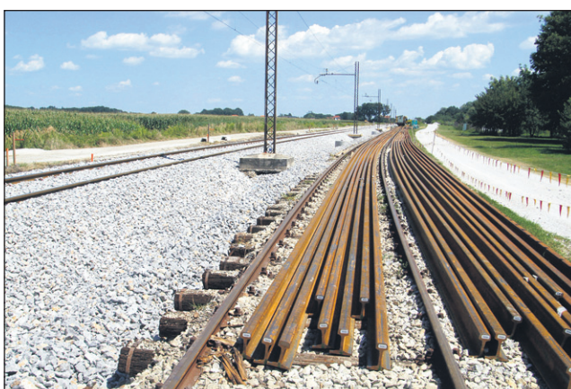
Foto: M. Ozmeč Del proge od Pragerskega proti Cirkovcam je že obnovljen, zamenjan je več desetletij star spodnji in zgornji ustroj, lesene tramove zamenjujejo z betonskimi, nove pa so tudi tirnice.
