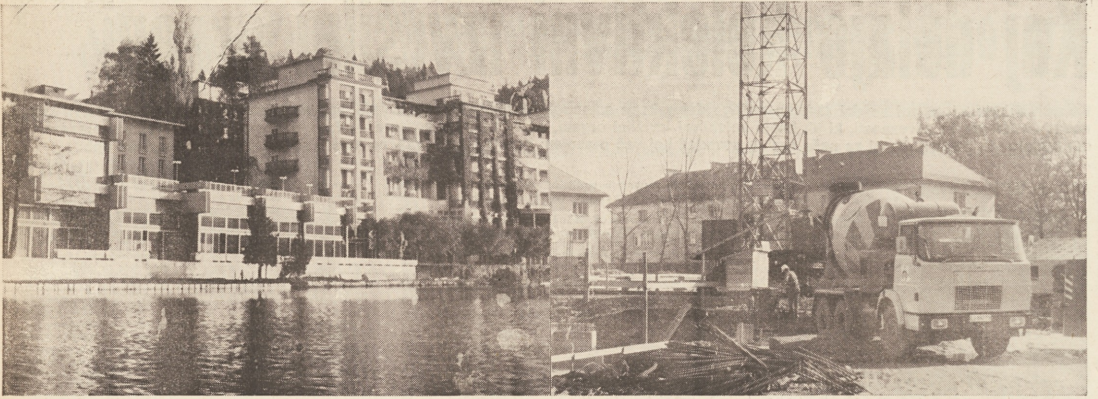
Levo: V naselju Planina bodo zgradili 2500 stanovanj; tule je začetek gradnje stolpnice — Desno: Adaptacija in nov trakt hotela Toplice na Bledu
