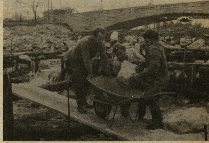
Reka Savinja iz leta v leto napravi precej škode pri jezovih. Lansko močno deževje in s tem tudi narasla Savinja sta močno poškodovala jez na Polzeli. Že nekaj časa ga popravljajo delavci NIVOJA iz Celja, ki upajo, da bodo dela opravili do jesenskega deževja.
