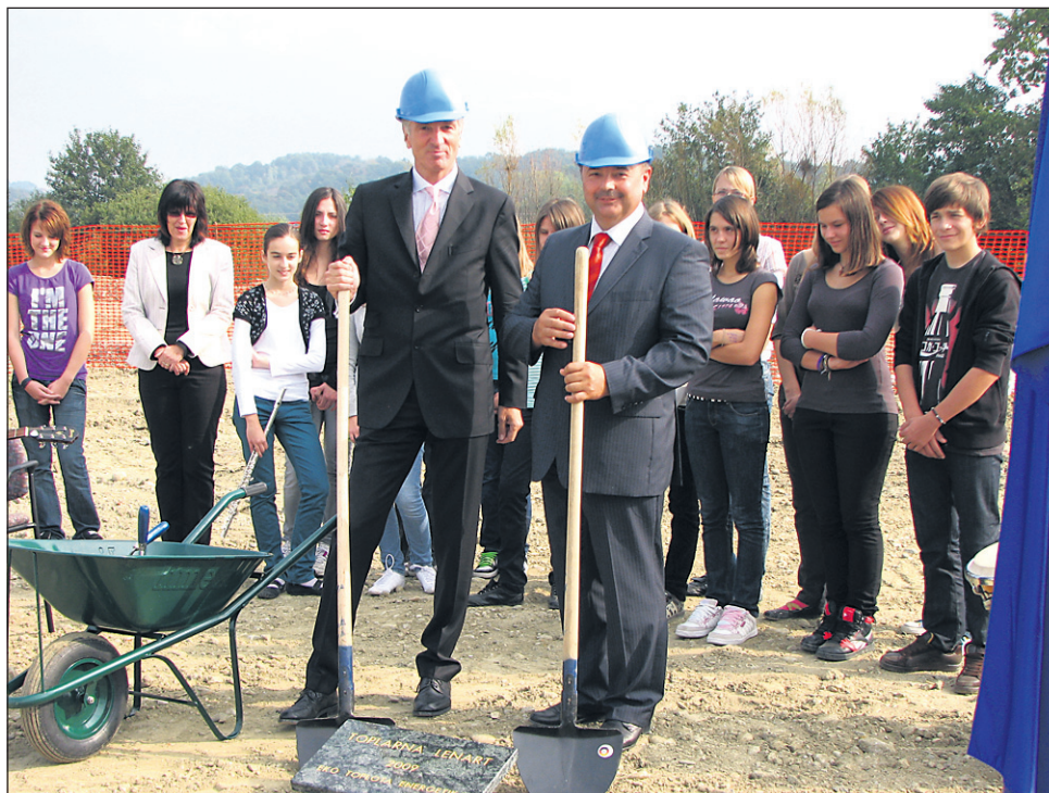
Župan Lenarta Janez Kramberger in predstavnik podjetja Kelag Harald Kogler sta položila temeljni kamen za toplarno.
