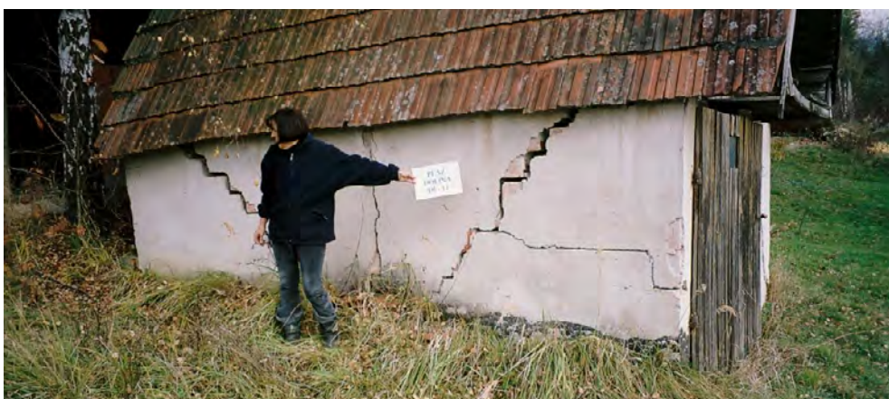
Sl. 4. Poškodbe na objektu na zahodnem delu Doline (poleg vrtine DI-11).
