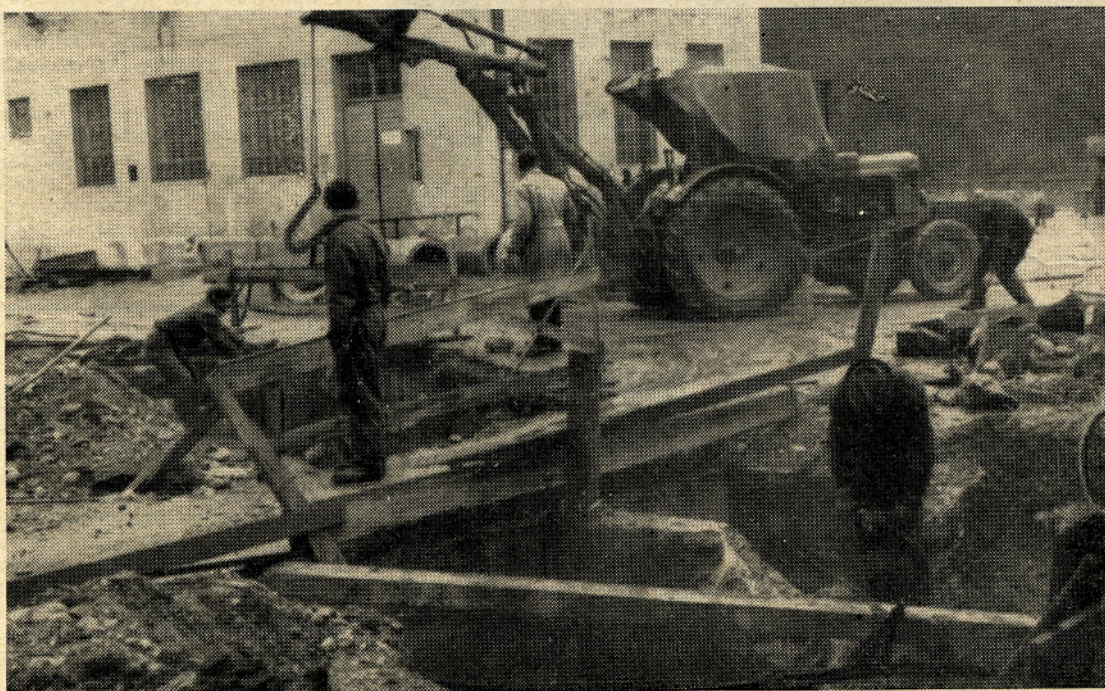
Se en detalj izpred plemenitilnice in kotlarne
