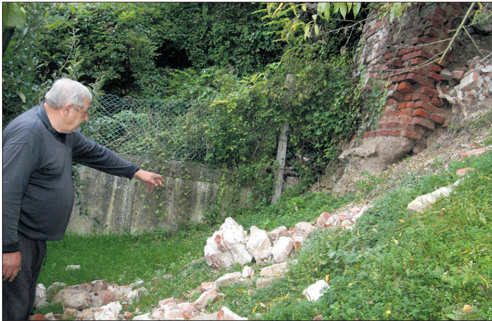
Franc Kramberger kaže na odkrušene dele mestnega obzidja, ki ogrožajo njihov sadovnjak in tudi njihovo varnost.
