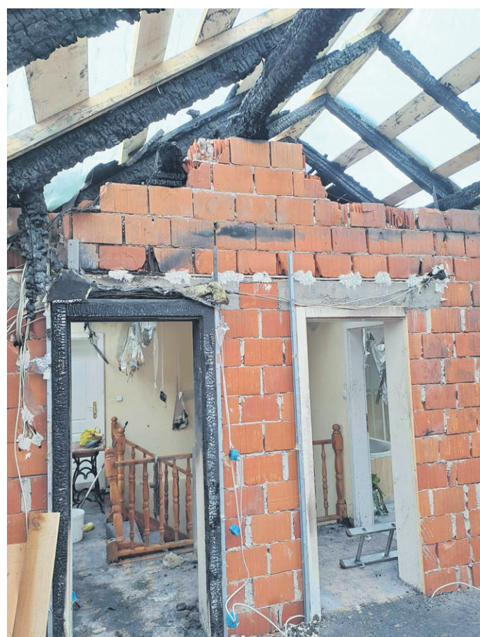
Žalosten pogled na pogorelo streho in uničeno podstrešje
