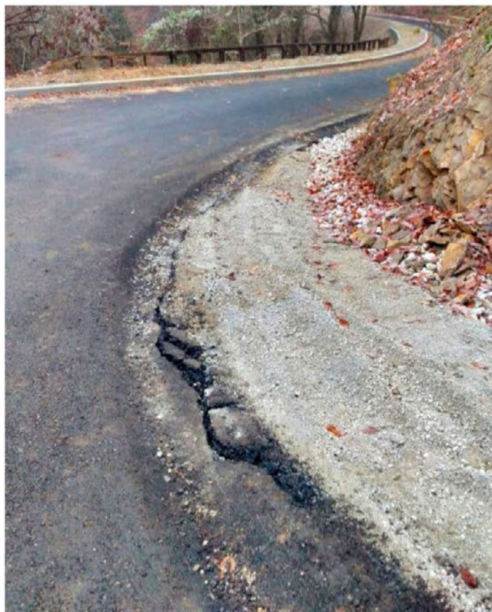
Poškodbe bankine z asfaltno prevleko vodnega toka
