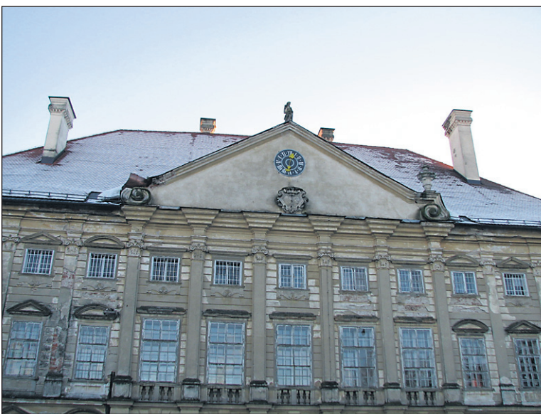
Potem ko je s strehe zgrmela velika okrasna vaza, zdaj grozi, da se bo podrl še dimnik.
