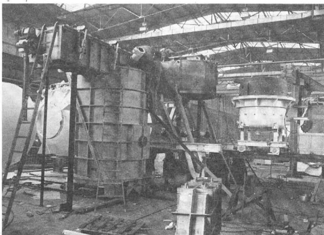
Peč na »hladnem testu« v Metalni
