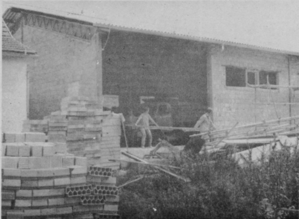
Delavci delovne organizacije IKOM Šmarje pri Jelšah gradijo novo skladiščno halo v obratu TT Prebold v Pristavi
