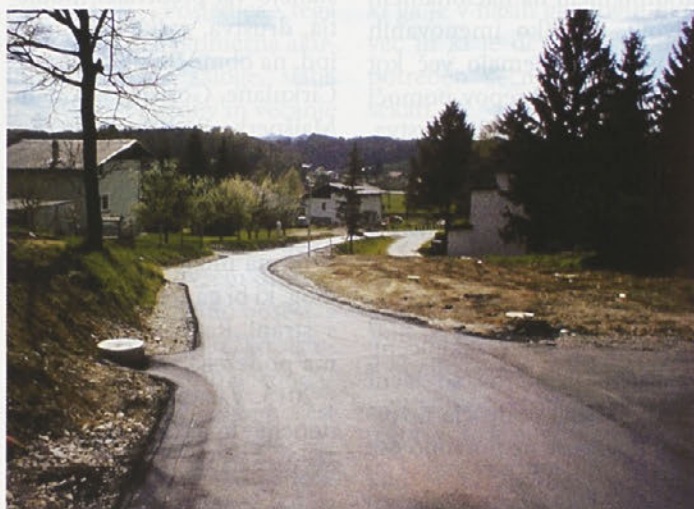
Zaključna gradbena dela – asfaltiranje obrabno-zaporne plasti v mesecu aprilu (Avtor M. Krajnc)
