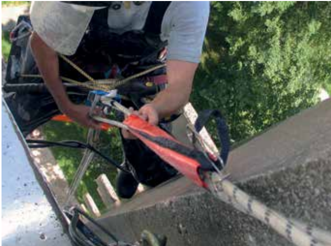
Slika 8: Nepravilnost- uporaba športne opreme, Petzl GRI-GRI (vir: avtorji).
