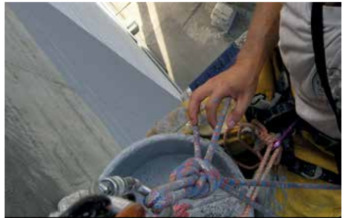
Slika 10: Nepravilnost - vpenjanje delovnega sedeža v napravo za spuščanje (vir: avtorji).
