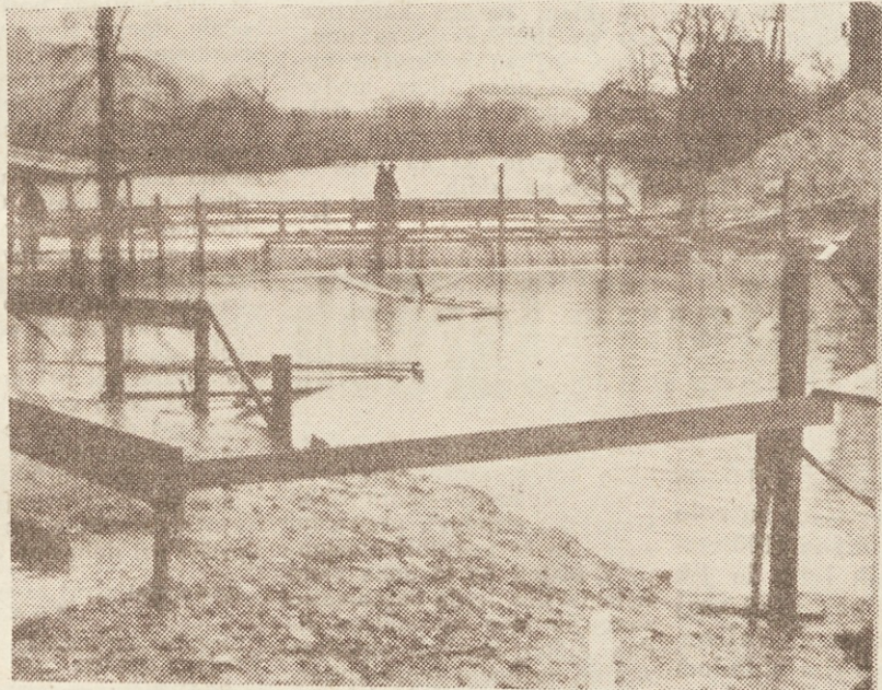
Poplava na gradbišču ljubljanske toplotarne. Do zadnjega smo upali, da je ne bo.
