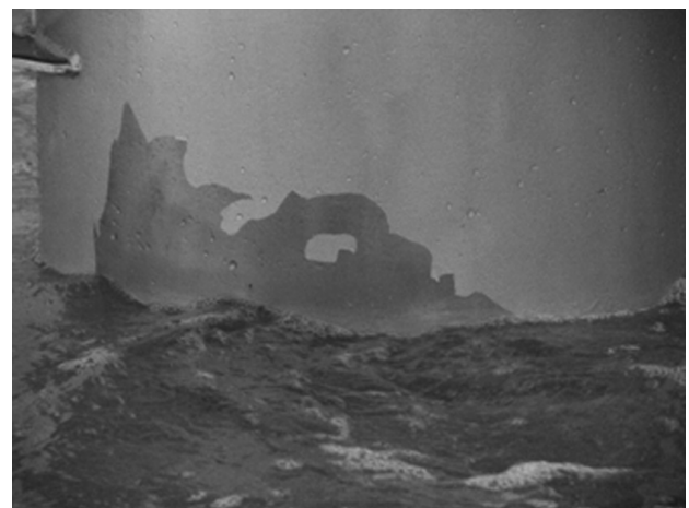
Figure 4: Protective coating peeling off of stainless steel structure Slika 4: Prikaz slabe površinske zaščite nerjavečje jeklene konstrukcije v kopalnem bazenu
