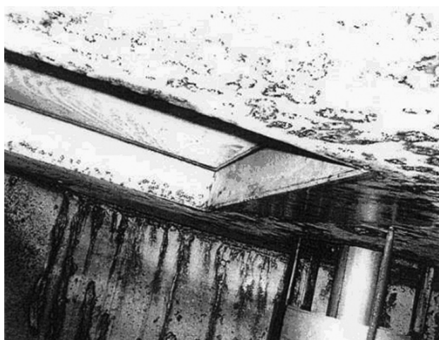
Figure 2: Corrosion inside a cold water reservoir Slika 2: Korozija v notranjosti rezervoarja hladne vode
