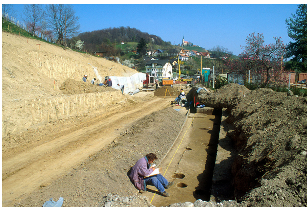
7 Pogled na malečniško cesto ob gradbenih delih v letu 2002; v ospredju sonda 1.
