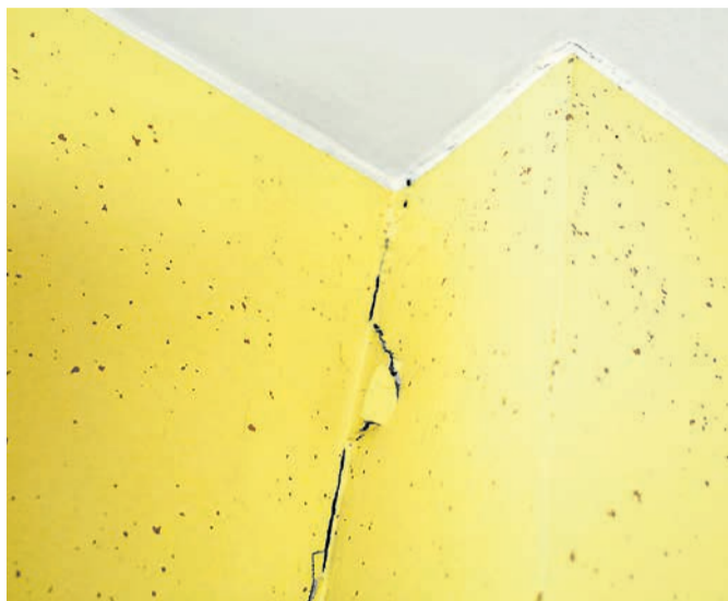
Sanacije manjših razpok zavarovalnica ne krije.
