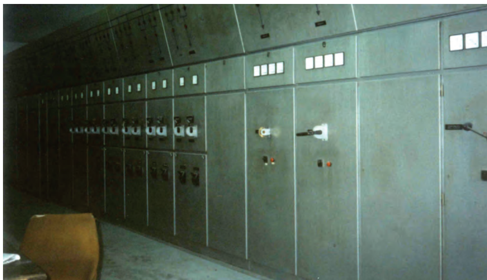
80. Elektro razdelilne omare s stikali za izklapljanje in vkapljanje posameznih obratov v energetskem obratu IUV. Okrog leta 1990. Avtor fotografije neznan. Domoznanski oddelek CKV.
