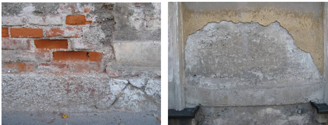
Slika 2.20: Zmrzlinke poškodbe opeke in ometa v območju podzidka (levo) in zaključnega sloja ometa (desno)
