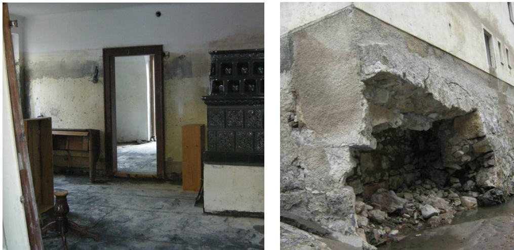
Slika 2.21: Nivo poplavne vode v notranjosti stavbe (levo) in poškodbe temeljne konstrukcije neposredno ob strugi (desno) med poplavami v Železnikih
