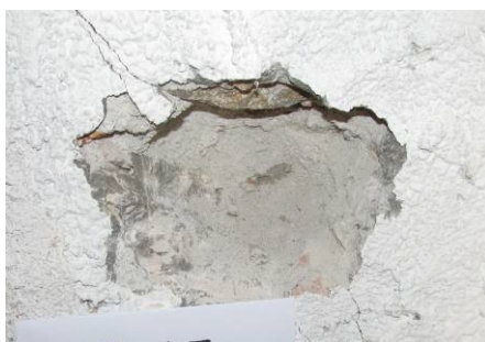
Slika 5.34: Globinska sonda izvedena na zidu 2-AC1 spodaj Fig. 5.34: In-depth probing at the bottom of the wall 2-AC1
