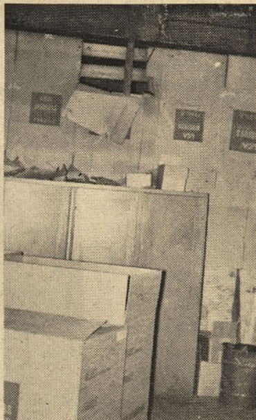
Vmesna stena med slikarnico in novim skladiščem je obita kar s kartoni in deskami. Na ta način je najlažji prenos požara iz stavbe v stavbo ali obrata v obrat.
