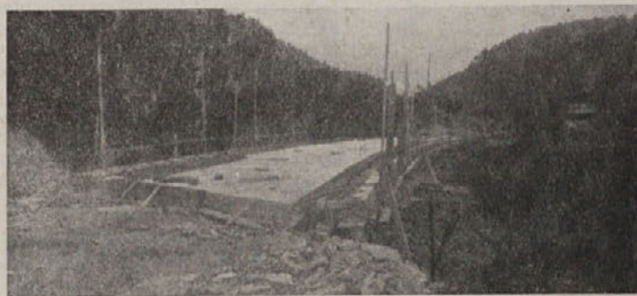
Na sliki: Dolgi nadvoz pri Zlebiču je dograjen, vendar opažev še niso pobrali. Sedaj montirajo na mostu ograjo, ko pa bo gotovo, bodo tudi čezenj potegnili asfaltni trak.
