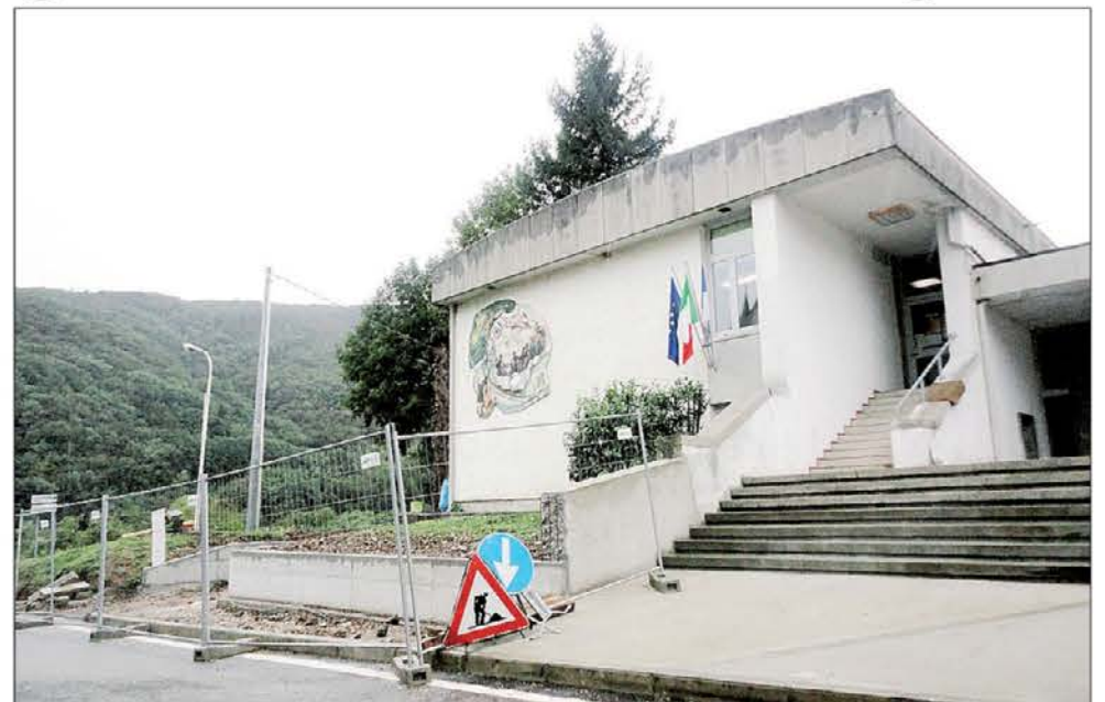
Un'immagine del cantiere per i lavori di ristrutturazione della sede della scuola secondaria di primo grado Dante Alighieri
