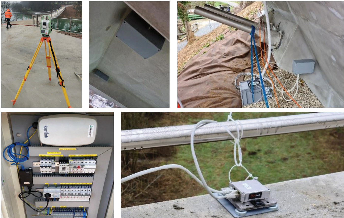
Slika 24. Trajne in začasne merilne naprave nameščene na konstrukcijo.
