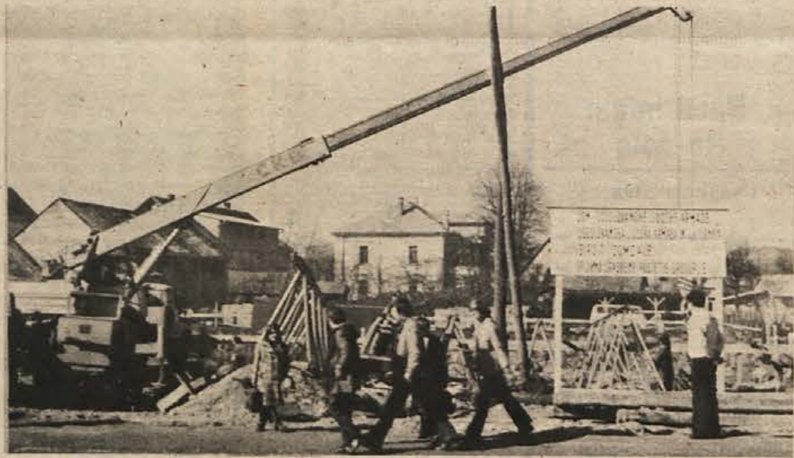
Gradnja doma JLA v Ribnici hitro napreduje, ker uporablja izvajalec del SGP Grosuplje pri delu tudi precej mehanizacije in ker pravo pomladansko vreme, čeprav je po koledarju zima, omogoča delo. (Foto: J. Primc)
