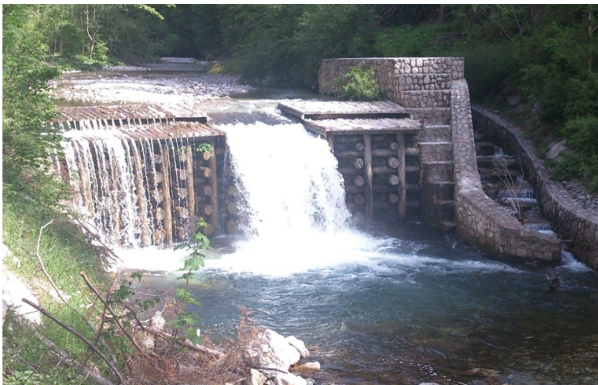
Slika 6: Neprimerno zgrajen kaštni jez na Kokri. Ob nizkem vodostaju voda pronica skozi podlago na vrhu jez, zato ribja steza ostane suha (foto: Andrej Draksler).
