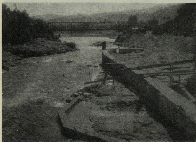
Sl. 4 Vdor vode v gradbeno jamo
