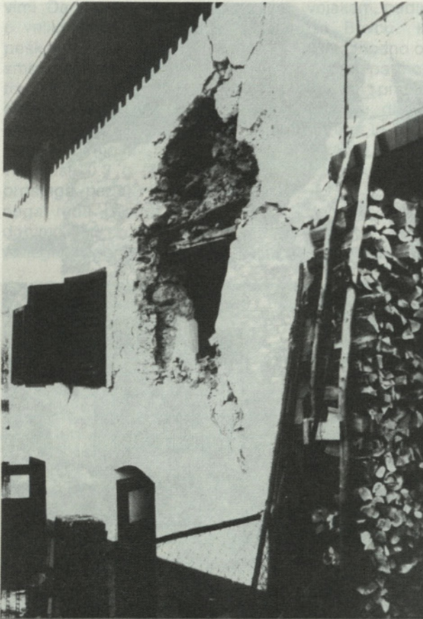
Slika 7: Drežniške Ravne: poškodovani vogal in delno porušeni kamniti zid v območju preklade
