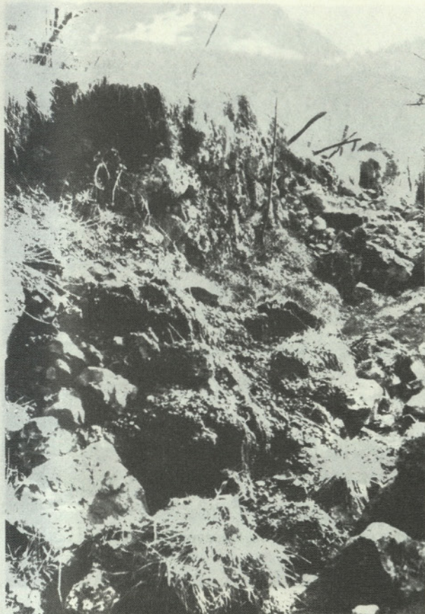
Slika 9: Drežniške Ravne: porušeni kamniti oporni zid na lokalni poti
