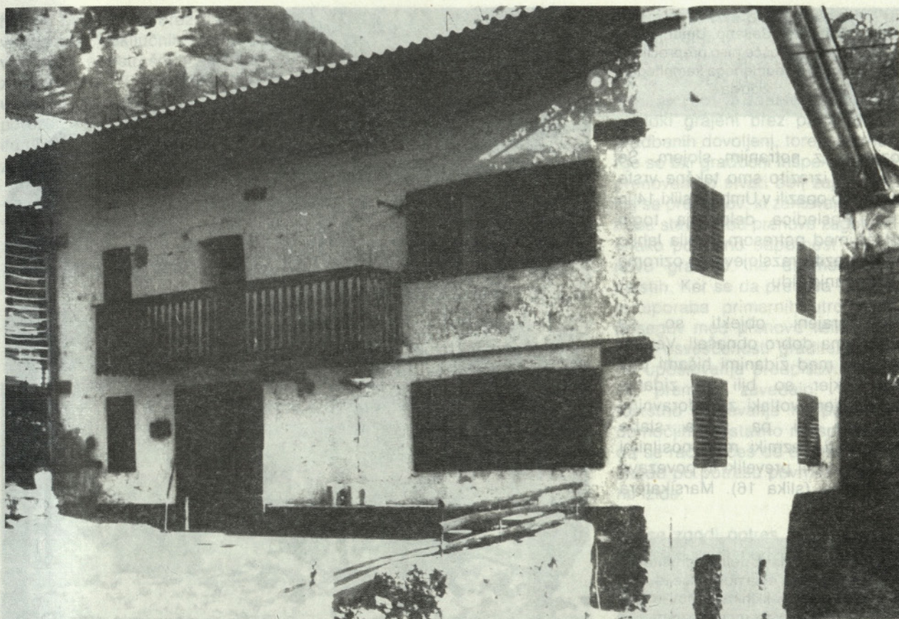
Slika 13: Tolminske ravne: po letu 1976 je bilo zidovje samo povezano z jeklenimi vezmi. Hiša na zunaj ni poškodovana, medtem ko je v notranjosti utrpela hujše poškodbe
