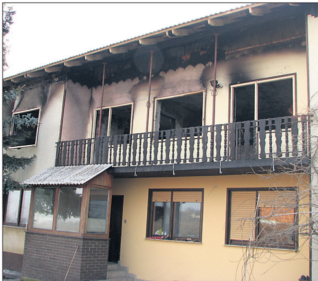
Po oceni strokovnjakov bo potrebno zgornjo etažo hiše porušiti.
