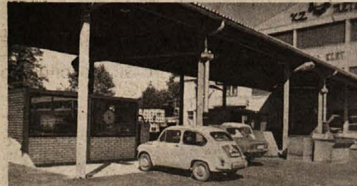
DO TRGATVE – V okviru investicije v posodobitev metliške Vinske kleti – veljala je 12 milijonov dinarjev – so pri kleti zgradili naj sodobnejšo sprejemnico grozdja. Postaviti je treba še cevovode, kar naj bi opravili do konca avgusta, in sprejemnica bo nared.
