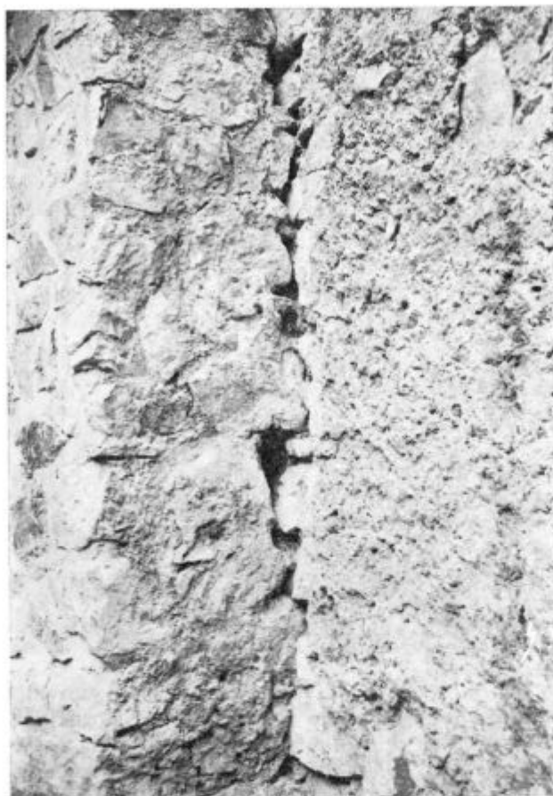
Jugovzhodni vogal v sektorju B. Vzhodna stena (na levi) je z izmeničnim zasekavanjem (šivani zid) upeta v severno steno stolpastega gradu (na desni), ki se nadaljuje v zidu proti vzhodu.
