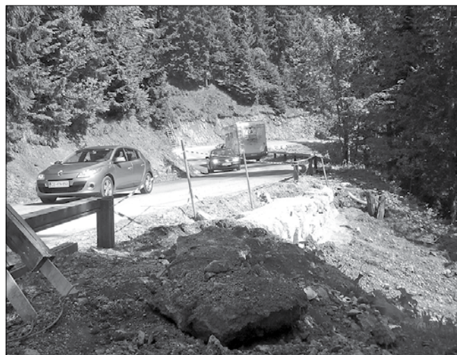
Podjetje Brlec d.o.o. sanira tri plazove, ki so se sprožili pod cestiščem na Golte po lanskim novembrskih poplavih. (Foto: Benjamin Kanjir)
