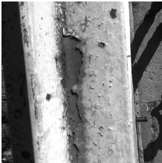
Slika 5: Korozija na jeklenem kotniku. Posnel avtor 7. 9. 2013 na dan odprtja razstave ob 100. obletnici Mariborske koč.
