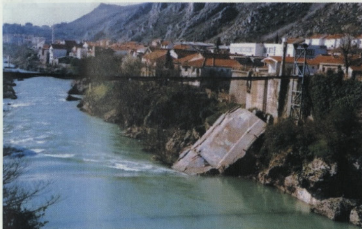
Slika 1 • Vojni porušeni most
