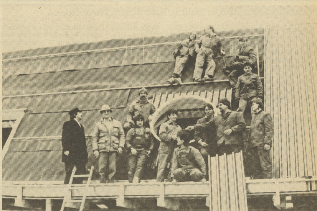
Termiški izolatorji na objektu – Marina Portorož
