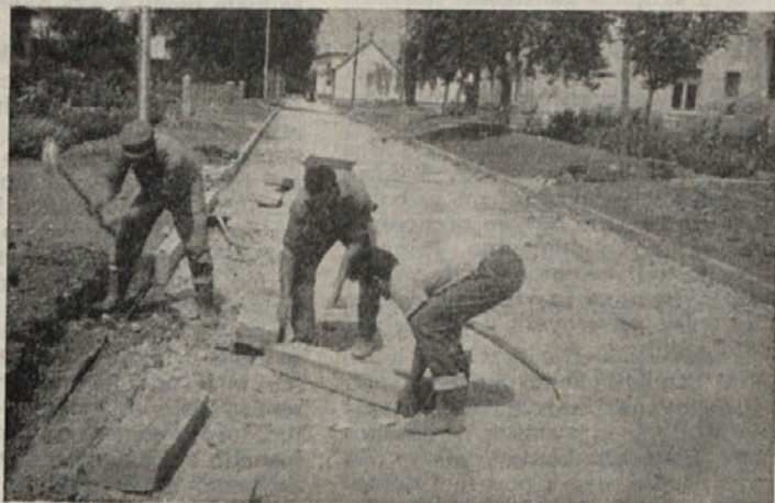
Dela na cesti proti Šeškovega domu dobro napredujejo. Prešernova cesta bo pripravljena za asfaltiranje do konca tega meseca, asfalt pa bodo nato polili v štirinajstih dneh
