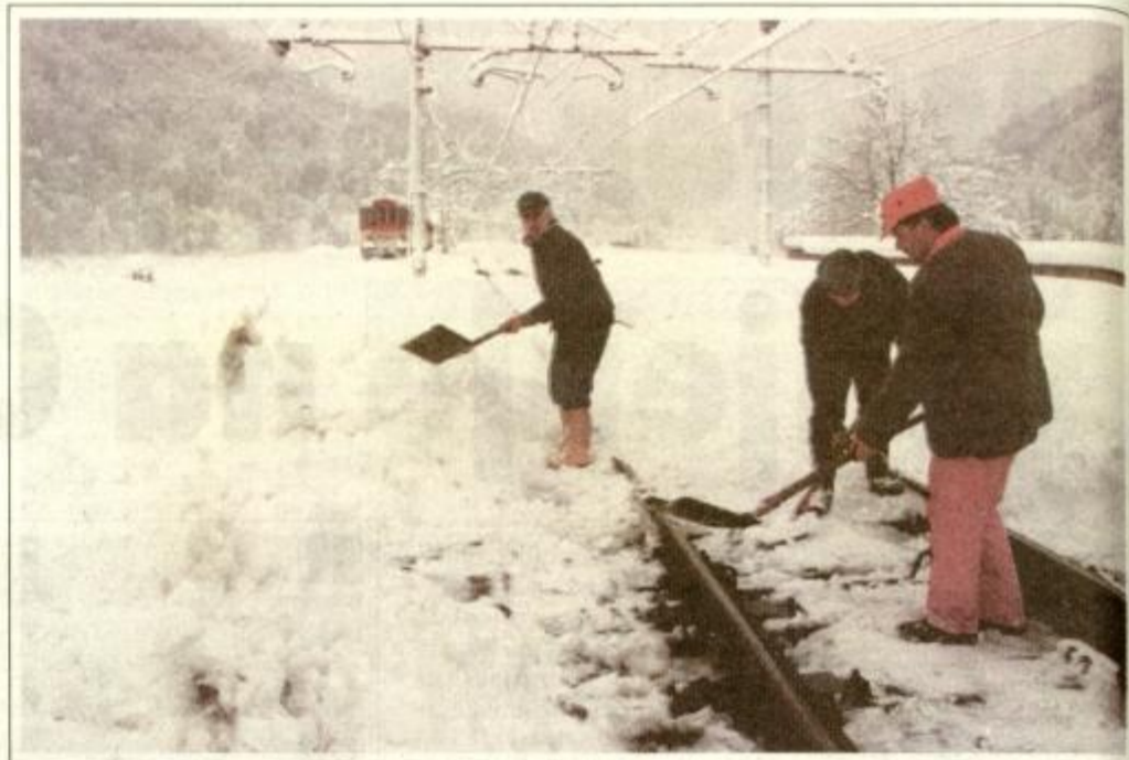
Ne samo na cestah, tudi na železnicah so bili zastoji. Z vso razpoložljivo mehanizacijo in tudi lopatami je bilo treba očistiti proge, kretnice, še največ težav pa so železničarji imeli zaradi podrtih dreves na proge. (Foto: GK)
