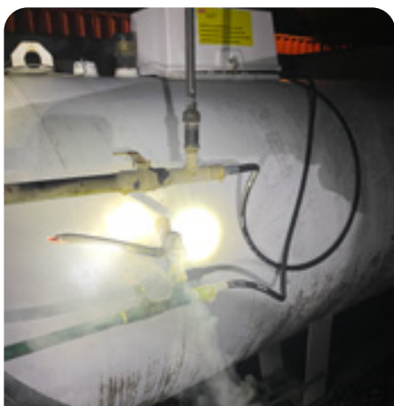
Puščanje plina pri zalogovniku na Gasilski cesti
